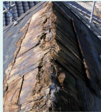
腐朽菌により老朽化した屋根
